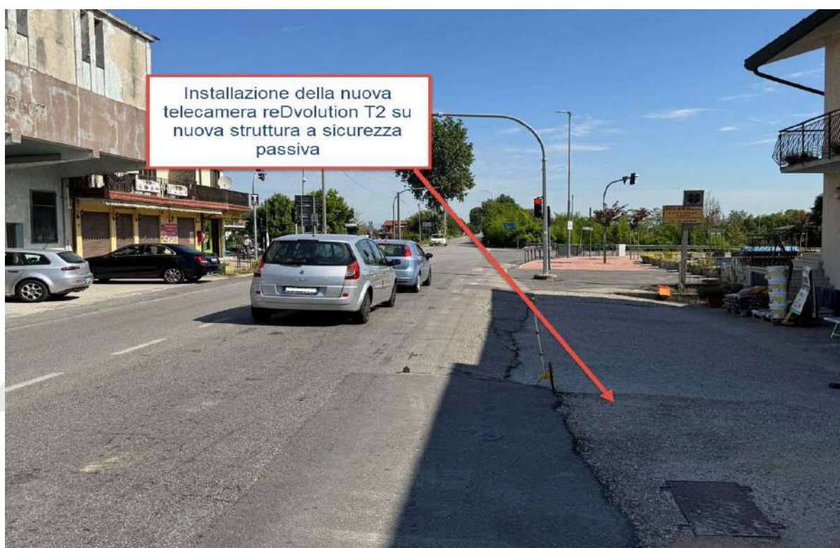
S.P.13 "Antico Alveo del Brenta" / Via Cavour km 5+030 lato sx direzione Dolo Telecamera reDvolution T2
