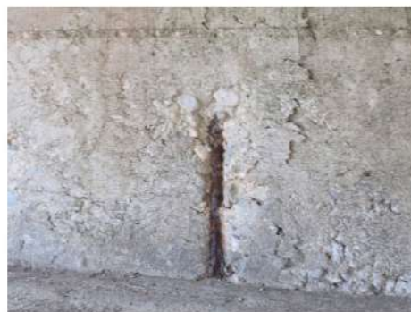
Foto 4: ove presente distacco del copriferro sulla spalla di valle, le armature affioranti sono corrose con riduzione della sezione resistente.
