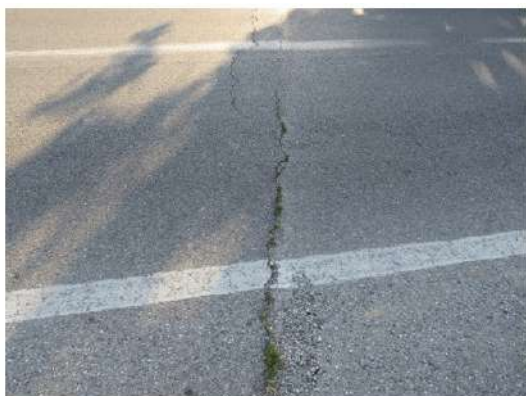
Foto 7: su entrambi i giunti si rileva la deformazione del tampone.
