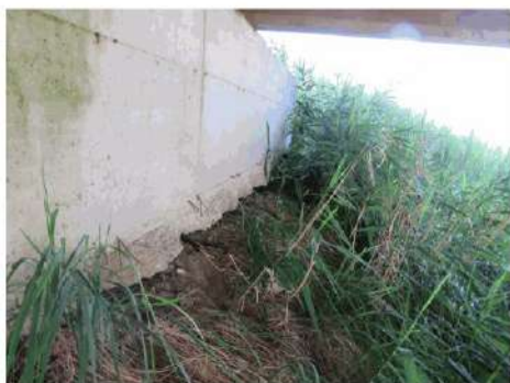
Foto 5: sotto tutta la spalla di valle e al centro di quella di monte si rileva lo scalzamento degli elementi per una profondità di circa 50 cm.
