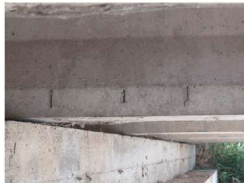
Foto 12: in rari punti sugli spigoli del bulbo inferiore delle travi si notano stiffe scoperte e ossidate.
