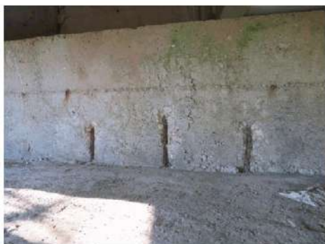
Foto 3: in alcuni punti sulla parte superiore della spalla di valle si riscontra il distacco del copriferro.
