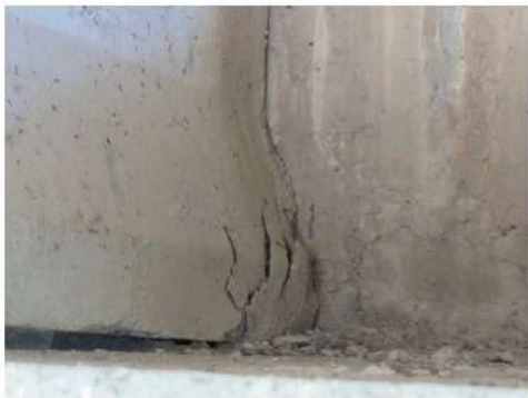
Foto 11: in alcuni punti agli appoggi delle travi, sugli spigoli inferiori, il copriferro è in procinto di distacco.
