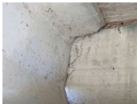
Foto 6: entrambi i muri paraghiaia sono umidi e dilavati, inoltre quello di valle in corrispondenza della testata della I trave da sinistra appare leggermente danneggiato.
