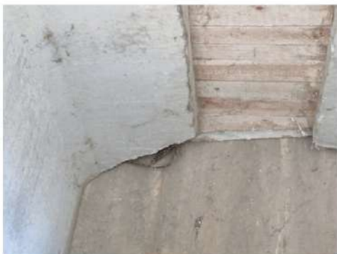
Foto 13: le piattabande di alcune travi presentano ferri di armatura in vista in corrispondenza delle testate.
