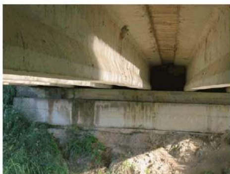
Foto 1: in ampie zone su entrambe le spalle sono presenti delle macchie di umidità.
