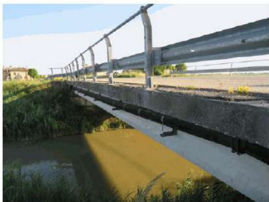
Foto 14: tutta la superficie delle facciate laterali della soletta appare dilavata.
