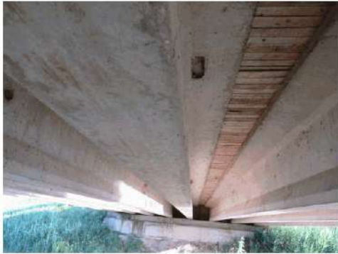
Foto 9: in poche zone all'intradosso delle travi sono presenti delle macchie di umidità.
