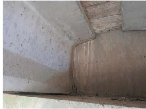
Foto 10: nella zona degli appoggi di tutte le travi è visibile il dilavamento del calcestruzzo per percolamento di acqua dalle sovrastrutture.
