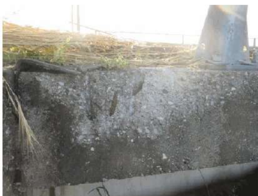
Foto 16: dove è avvenuto il distacco del copriferro sulla facciata laterale destra della soletta, le armature affioranti sono ossidate.
