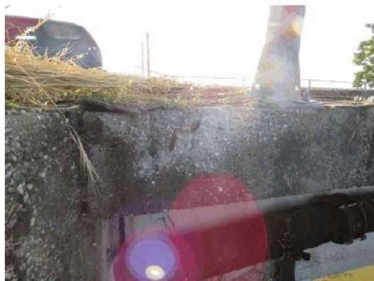
Foto 15: sulla facciata laterale destra della soletta in corrispondenza delle estremità di monte e valle si riscontra il distacco del copriferro.
