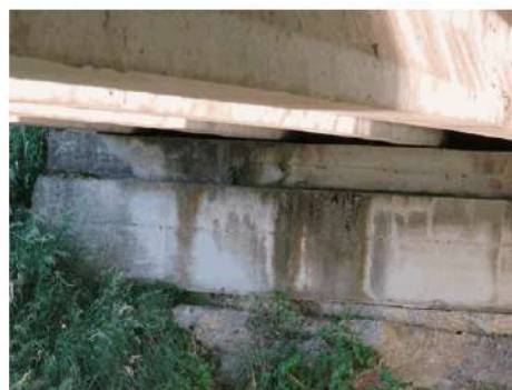
Foto 2: in zone estese di entrambe le spalle, specialmente verso i bordi laterali, il calcestruzzo risulta dilavato.
