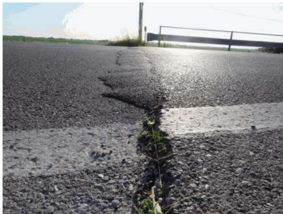
Foto 18: in corrispondenza della spalla di monte è presente un dislivello tra rilevato ed impalcato.
