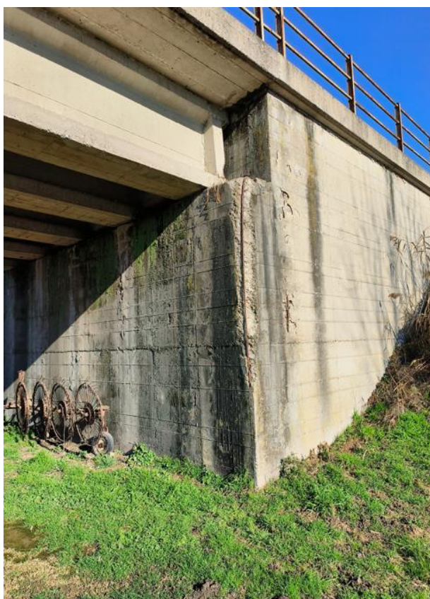
Figura 10 – Spalla 2 – Dilavamento del calcestruzzo con armatura ossidata
