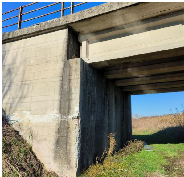
Figura 9 – Spalla 1 - Dilavamento, distacco di copriferro e armatura ossidata
