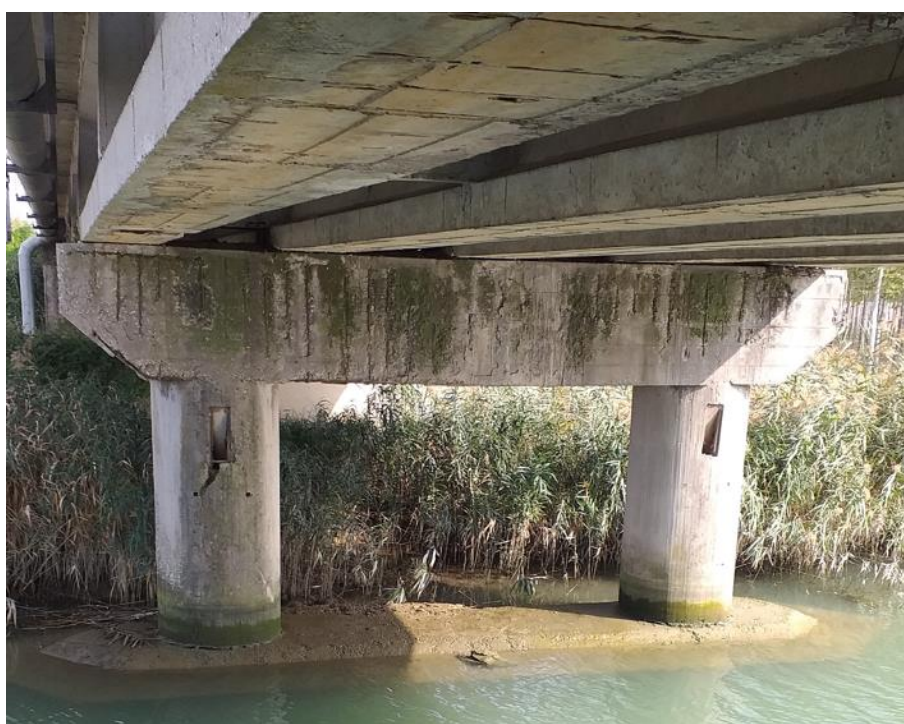
Figura 8 – Pila 2 – Dilavamento con distacco di copriferro ed armatura ossidata
