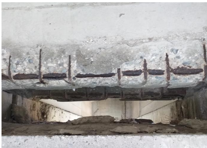
Figura 6 – Distacco di copriferro ed armatura corrosa
