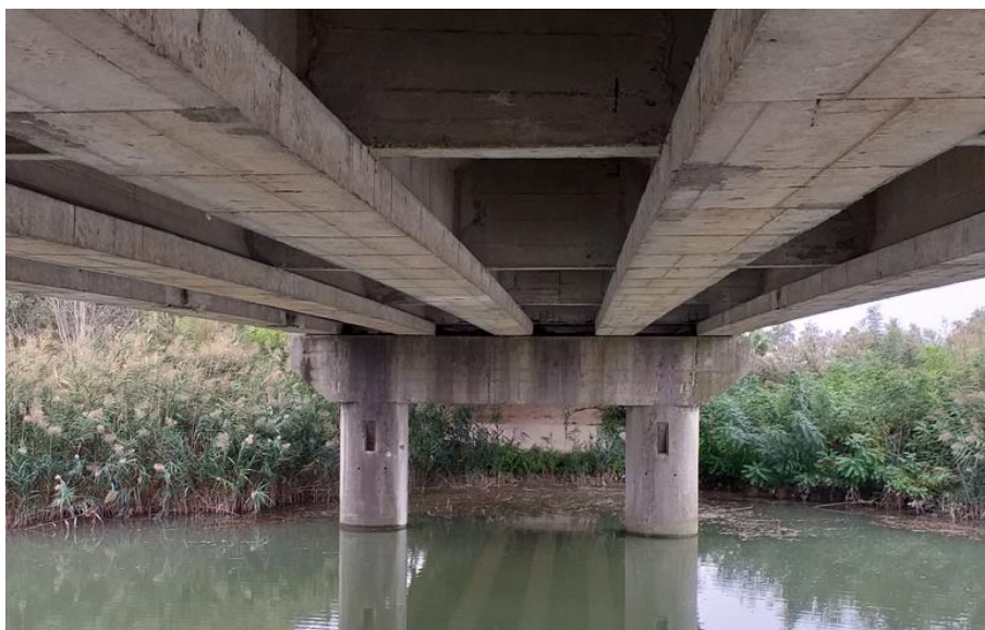
Figura 7 – Pila 1 – Dilavamento con distacco di copriferro ed armatura ossidata
