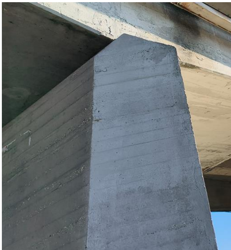
Figura 8 – Pila 1 – Vespai e distacco di copriferro
