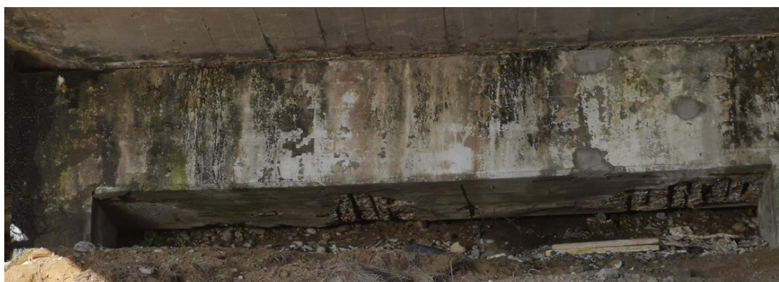
Figura 5 – Spalla 1 – macchie di umidità, dilavamento, distacco di copriferro e armatura ossidata
