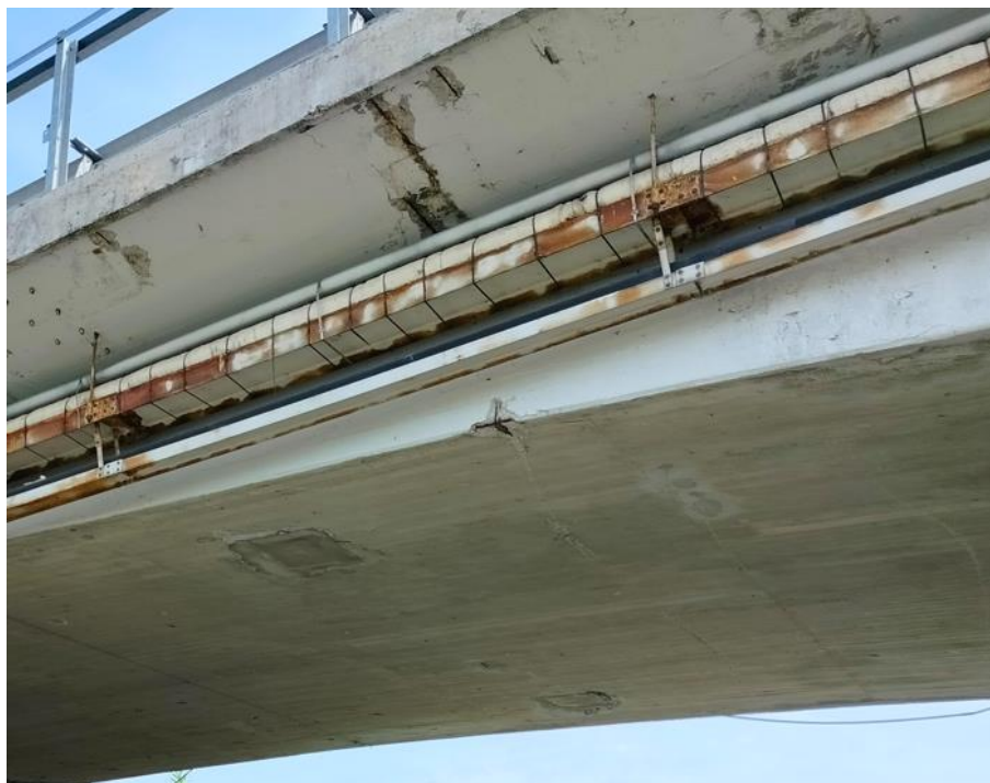
Figura 12 – Prima campata – danno da urto
