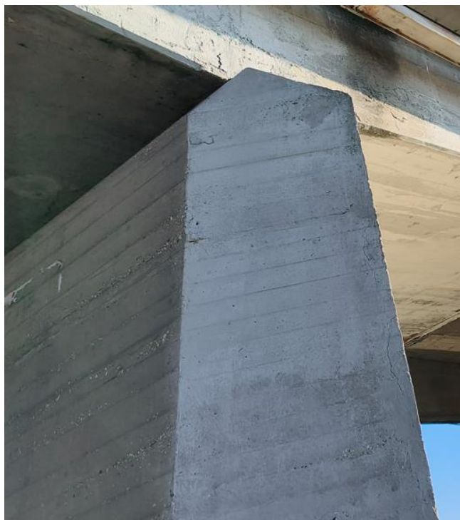
Figura 10 – Pila 1 – Vespai e distacco di copriferro
