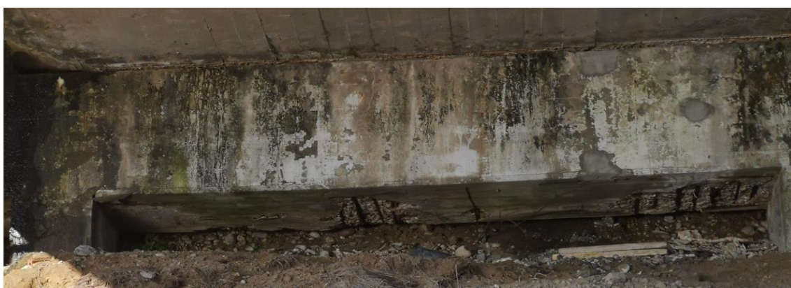
Figura 7 – Spalla 1 – macchie di umidità, dilavamento, distacco di copriferro e armatura ossidata
